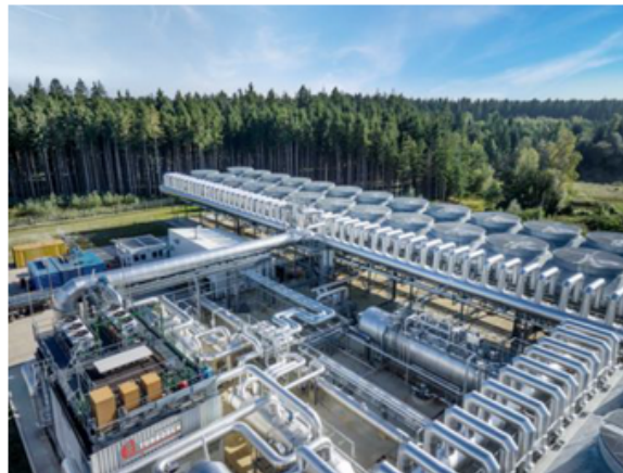
Geothermie Holzkirchen GmbH plant overview
